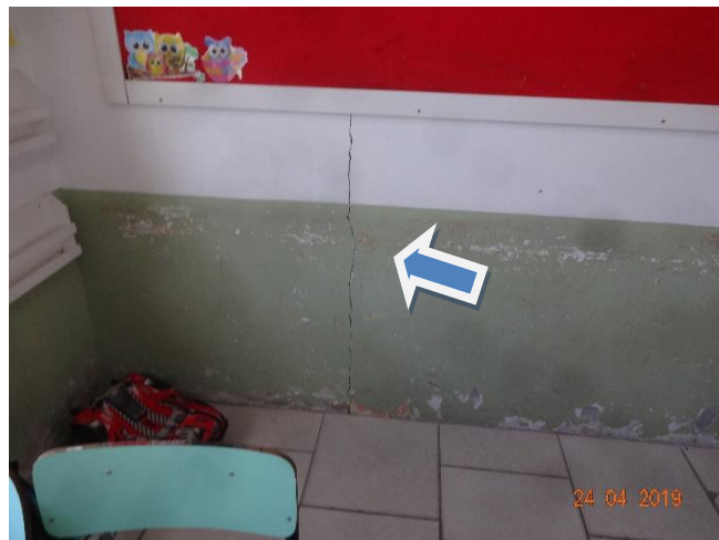
Figura 07: Detalhe da fissura na parede
