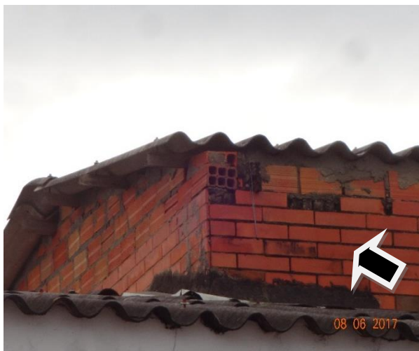
Figura 01: Detalhe da deficiência de acabamento
