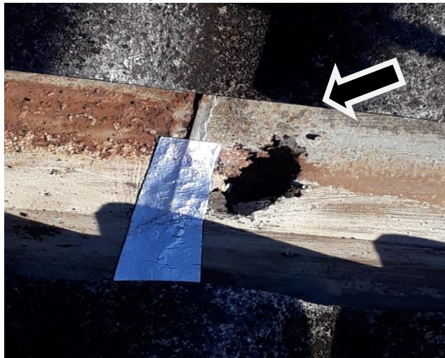
Figura 03: Detalhe da calha precária sobre o telhado da Sala de Informática
