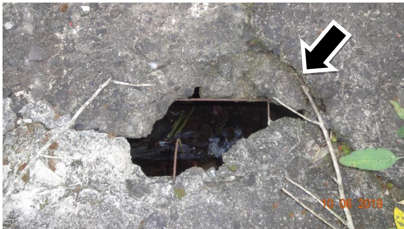
Parte da laje a ser reparada
