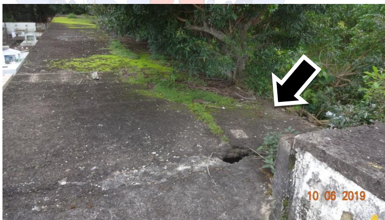
Parte da laje a ser reparada
