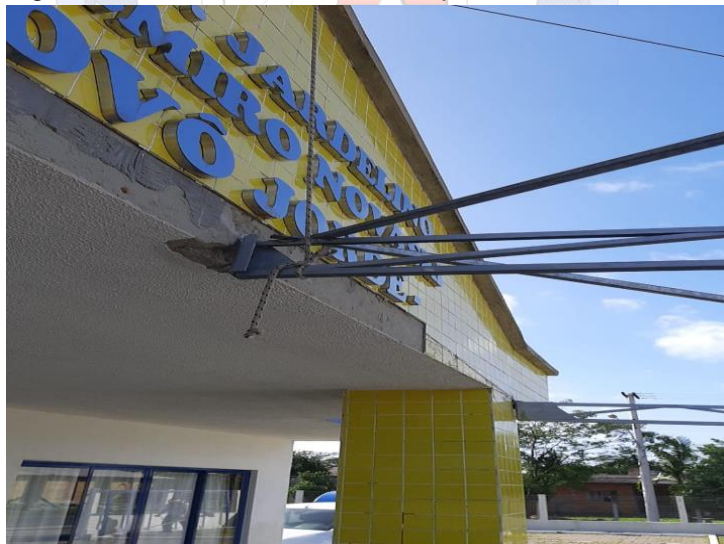
Figura 03: Detalhe do revestimento que sofreu descolamento
