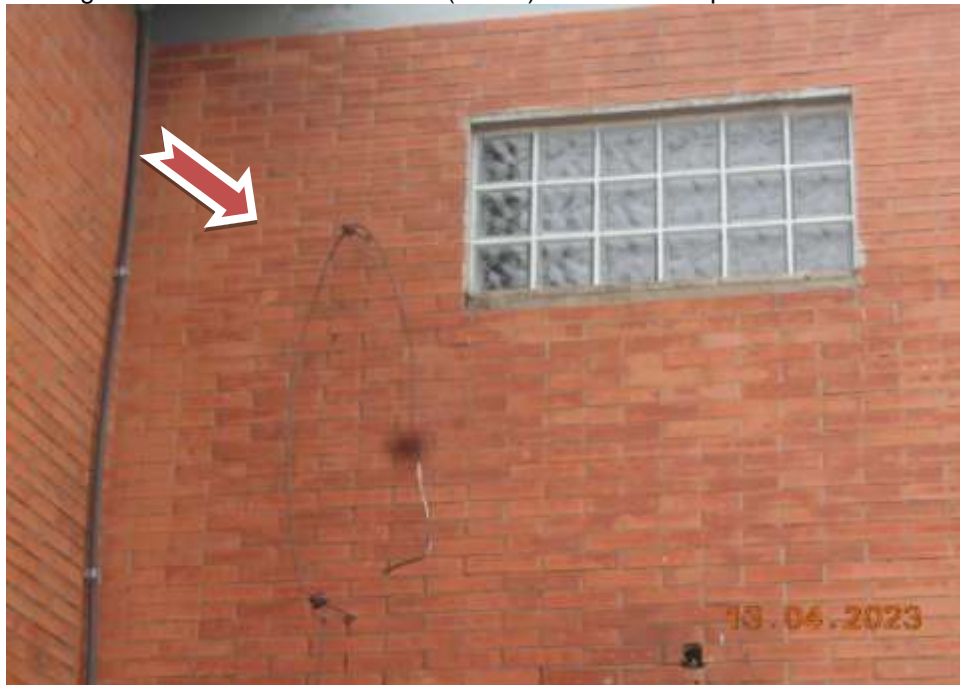
Figura 01: Detalhe da cordoalha (SPDA) danificado na parede da escola
