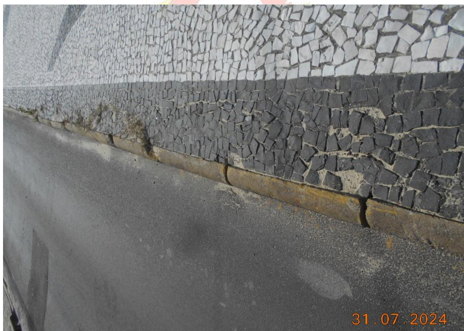
Meios-fios sem rejuntamento
