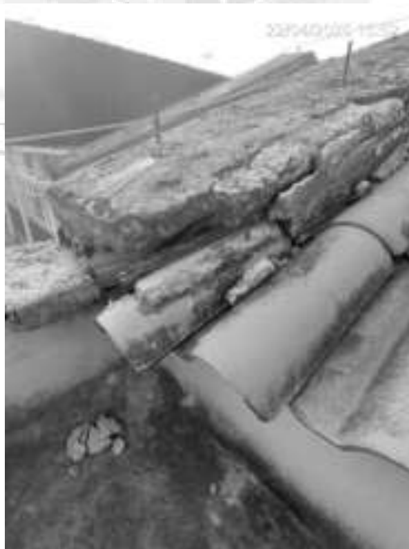
Figura 12: rufo em concreto com enchimento existente
