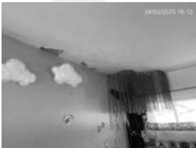
Figura 18: danos no teto das salas
