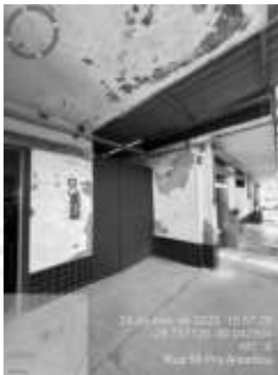
Figura 16: Parede e teto com reboco comprometido
