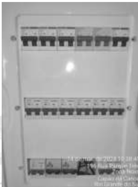
Figura 28: Quadro com proteção.
