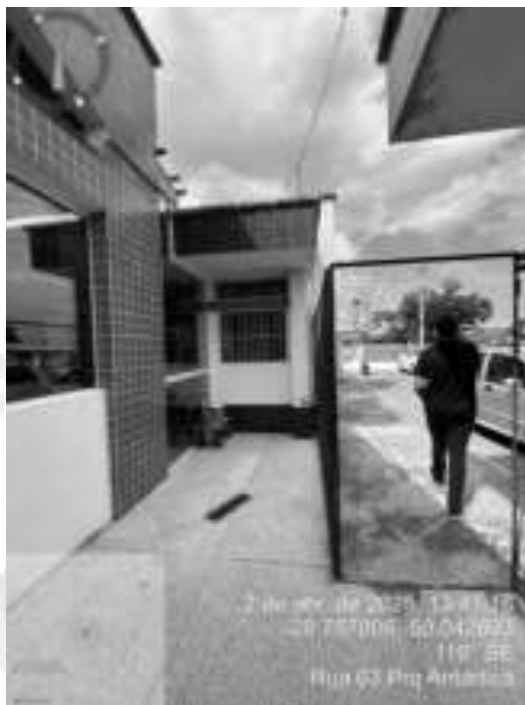
Figura 32: piso em granitina que necessita de reparos
