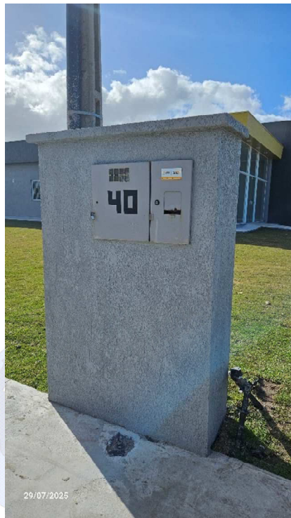
Imagem 02 – Medição de energia e água existentes.
