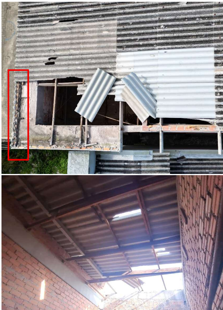
Figura 3 – Terças de madeira que deverão ser trocadas
