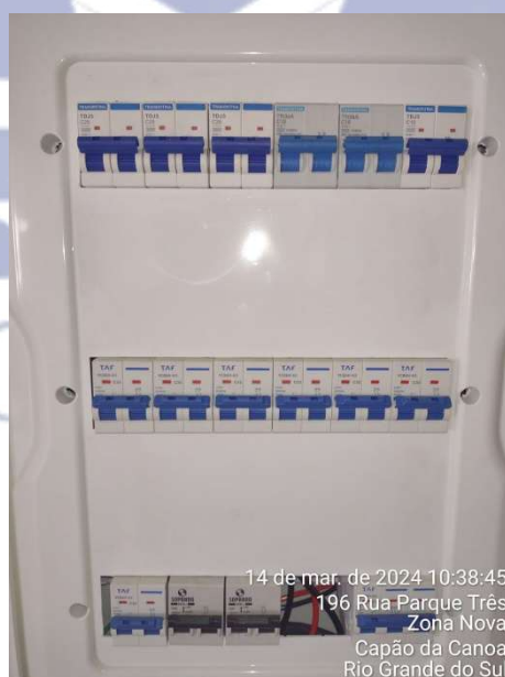
Figura 2 – Quadro com proteção.
